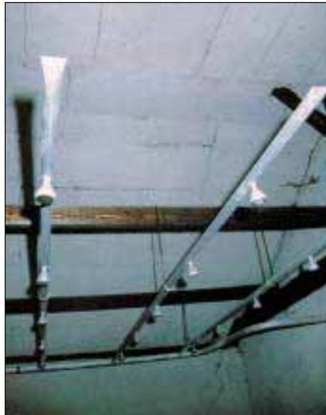
Abbildung 19: Wasserrohrsystem mit Duschköpfen im Entwesungstrakt des Bauwerkes BW 5b. Diese Wasserrohre haben keinerlei Anschluß, sie enden in den Entlüftungsöffnungen. Siehe Abbildung 20.
