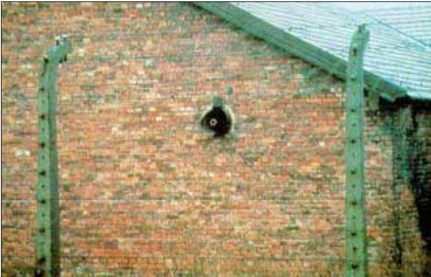
Abbildung 20: Entlüftungsöffnungen des Entwesungstraktes des Bauwerkes BW 5b, heute ohne Apparaturen. Man erkennt darin die Enden der Wasserleitungen, siehe auch Abbildung 19.
