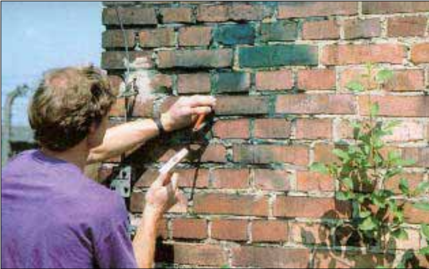
Abbildung 64: Die Außenwand des Blausäure-Entwesungstraktes des Bauwerkes BW 5a im Hochsommer 1991. Geringe Mengen an Cyanid, die durch die Mauer diffundierten, färben die Wand bis heute stellenweise blau. 50 Jahre widrigste Witterungsverhältnisse taten dem keinen Abbruch.
