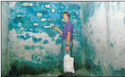
Abbildung 55: nordwestlich gelegener Innenraum des Zyklon B-Entwesungstraktes des Bauwerkes BW 5a im KL Auschwitz-Birkenau.
