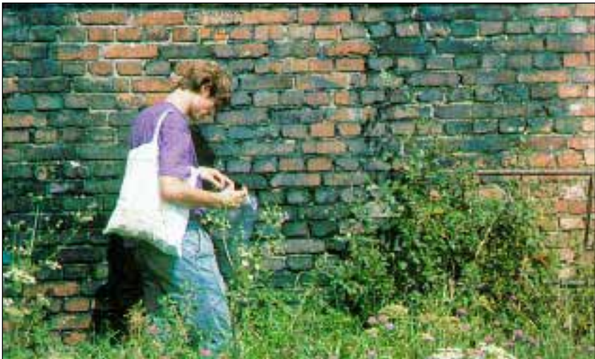
Abbildung 67: Im Gegensatz zum Bauwerk BW 5a (siehe Abbildung 64) wurde der Entwesungstrakt des Bauwerkes BW 5b länger als Blausäure-Entwesungskammer benutzt. Dementsprechend ist dessen Außenmauer über große Flächen blau gefärbt, auch hier unbeeindruckt von 50 Jahren Witterungseinflüssen.
