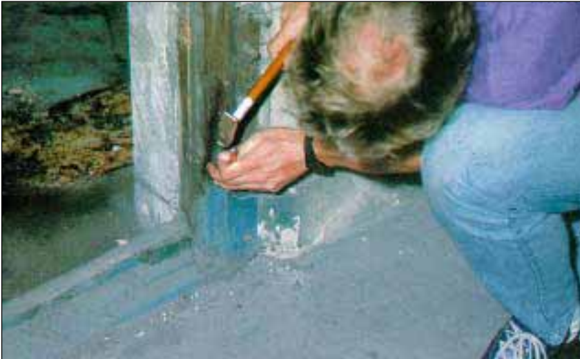
Abbildung 66: Aufnahme des Türpfostens aus dem Entwesungstrakt des Bauwerkes BW 5a, dessen unteres, rostiges Scharnier mit Blausäure Eisenblau gebildet hat. Entnahmestelle der Probe Nr. 18.
